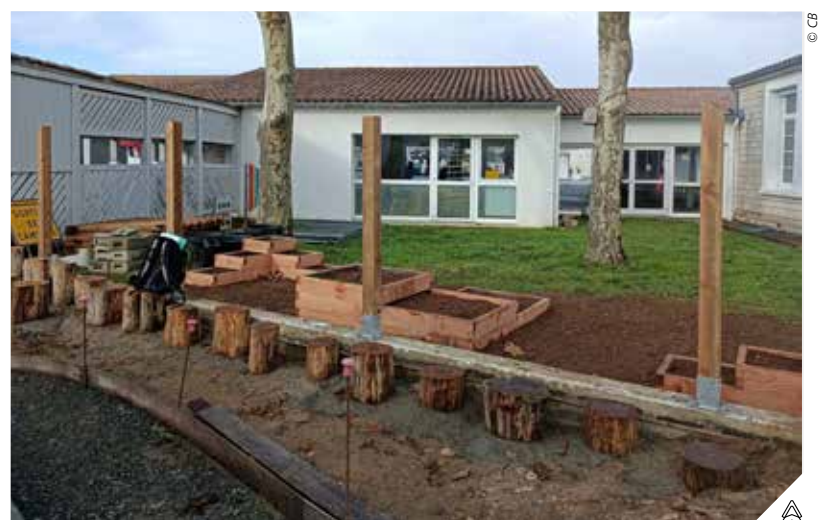
Dans le cadre de l'obtention du label Ecolo-crèche, la crèche Les Bigorneaux a été aménagée de façon innovante.
